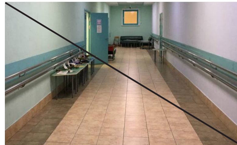
Плохо Керамогранитная плитка с крупными швами
